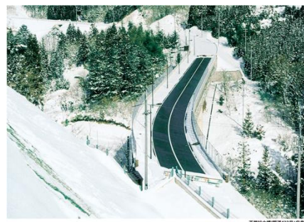
【写真13：地中熱利用路面融雪システム】
